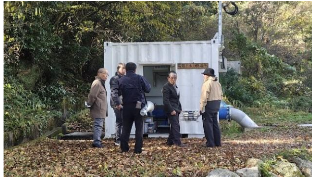
住民出資で運営されている「松隈小水力発電所」
