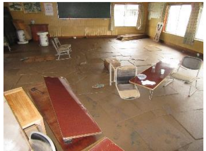
浸水当時避難者がいました。浸水はこの写真に写る窓の下部に達しています。カーペットは散乱、泥に覆われました。(二串町公民館)
