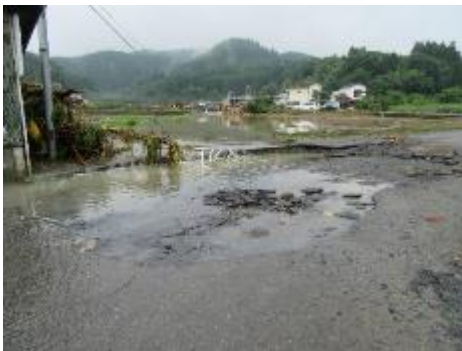
本来は水の流れはありませんがアスファルトはえぐられ、川となっていました。(山田町県道交差点付近)
