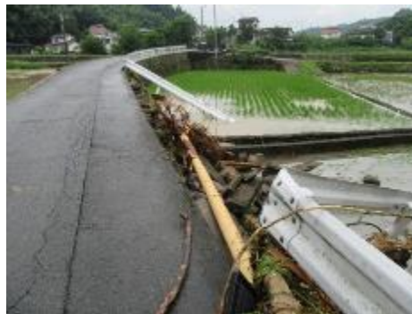
田んぼは川となり、道路の高さを越えた濁流はガードレールを破断、法面を破壊しました。(下山田付近)
