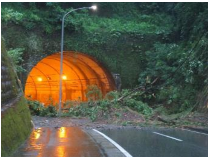
法面が崩壊し電線も垂れ下がっています。翌日には土砂は撤去されましたが、現在も歩道は通ることができません。(朝日トンネル小迫町側)
